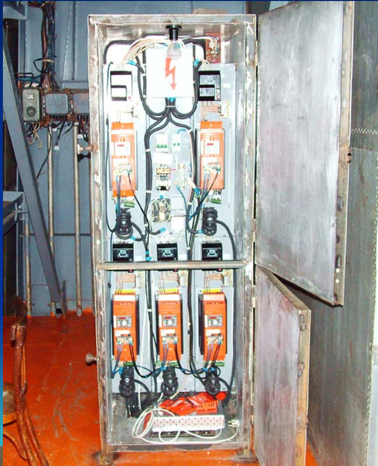
Шкаф управления двигателями
